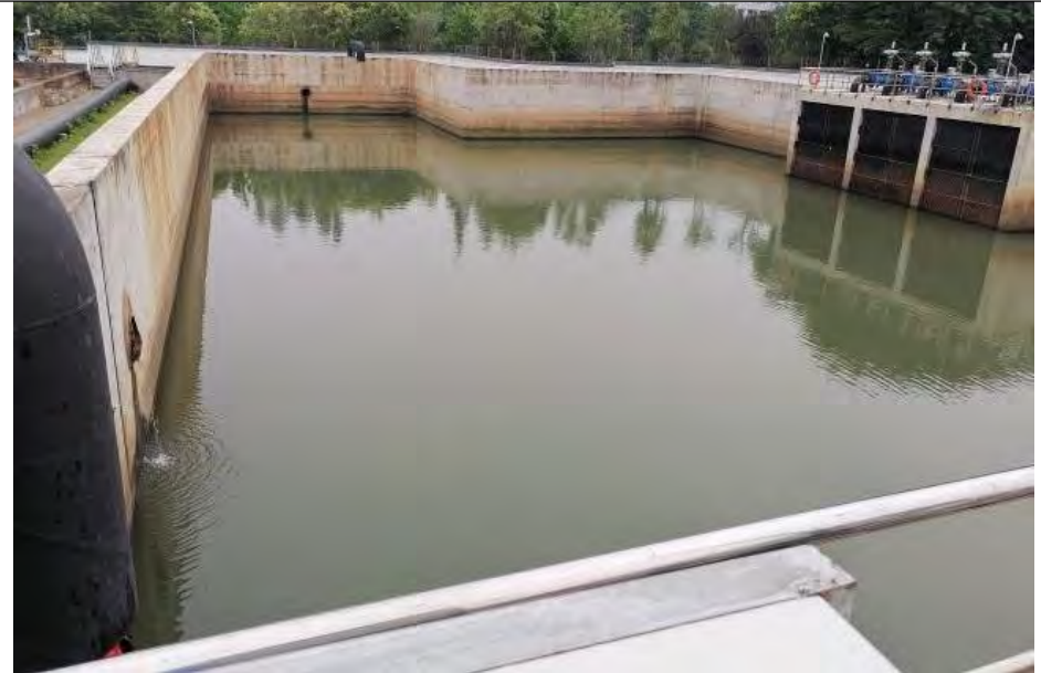
炼油老区雨水监控池
