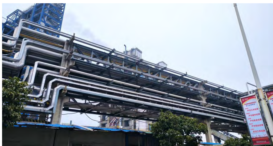
合成氨单元锅炉废水输送管线
