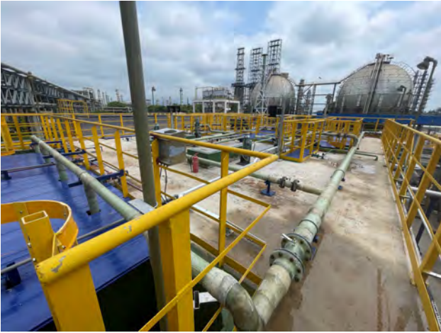
新建气化污水破氰处理设施废气密闭收集
