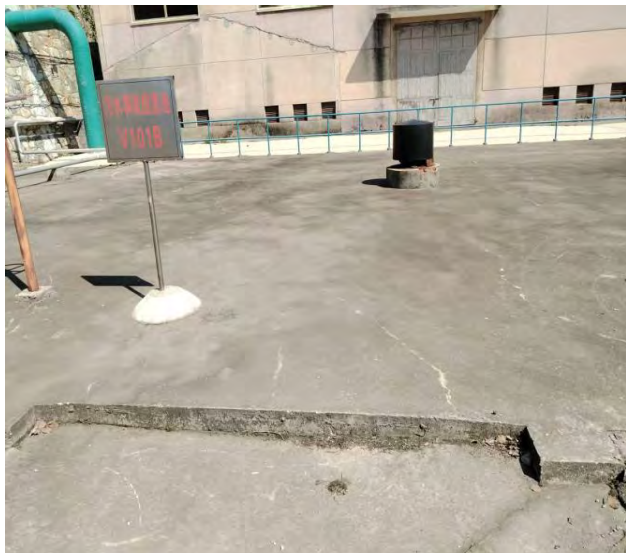
化工一部现有 1 座污水应急池（有效容积 1600m 3 ）
