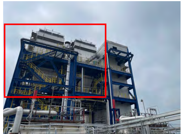
粉煤加压及输送废气新建2套布袋除尘器
