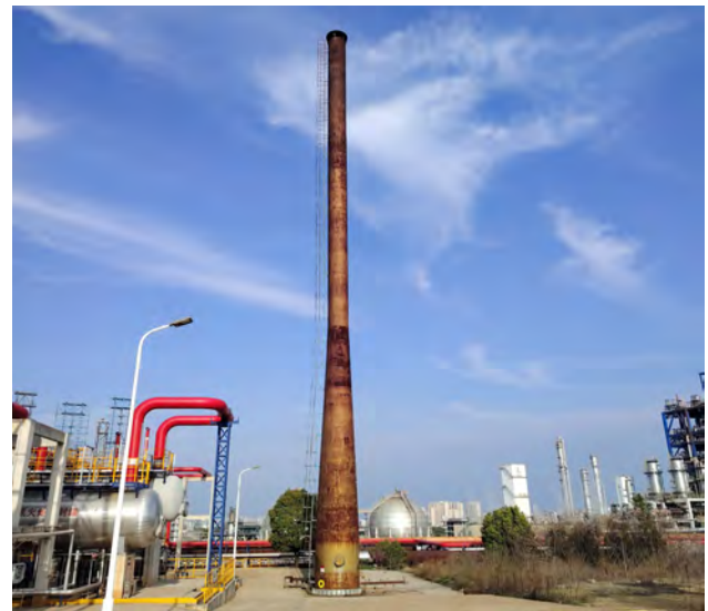
尾气洗涤塔废气现有排气筒
