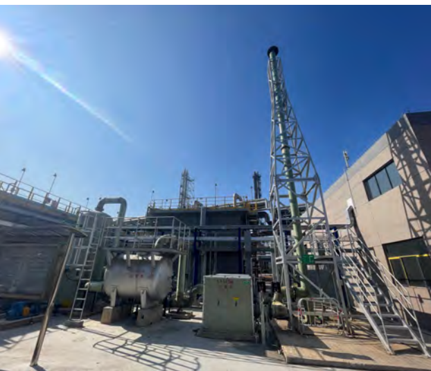
新建的1套“碱洗塔+活性炭吸附罐”+新建1根15米高排气筒 DA095
