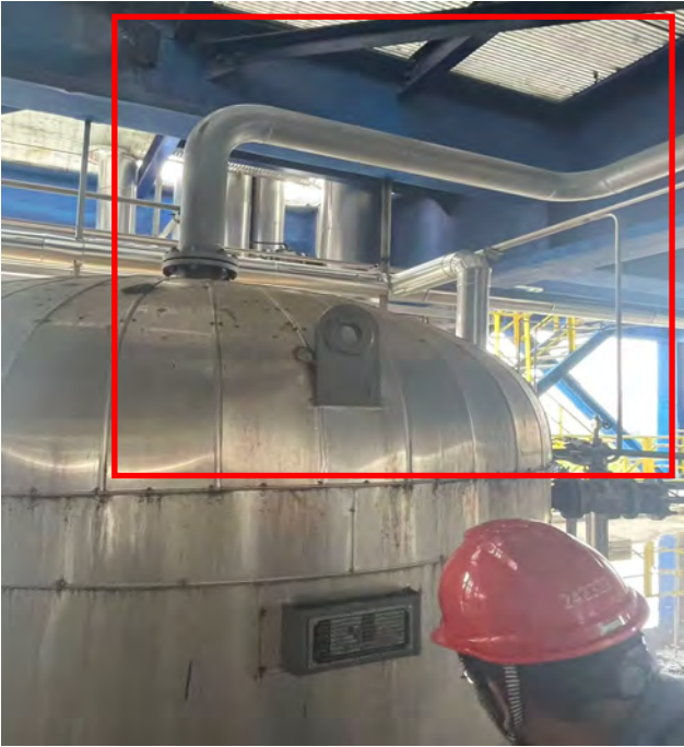
冲洗水罐密闭收集
