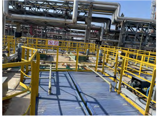
新建气化污水除氨氮设施废气密闭收集
