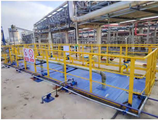
新建 105t/h 除氨氮处理设施（除硬反应池）
