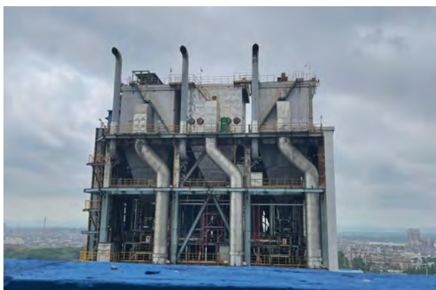
磨煤干燥废气现有 3 套布袋除尘器+3 根 94m 高排气筒 (DA005、DA007、DA049) (2 开 1 备)
