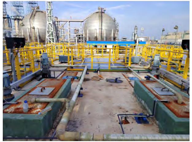
新建 105t/h 除氨氮处理设施（高密池）
